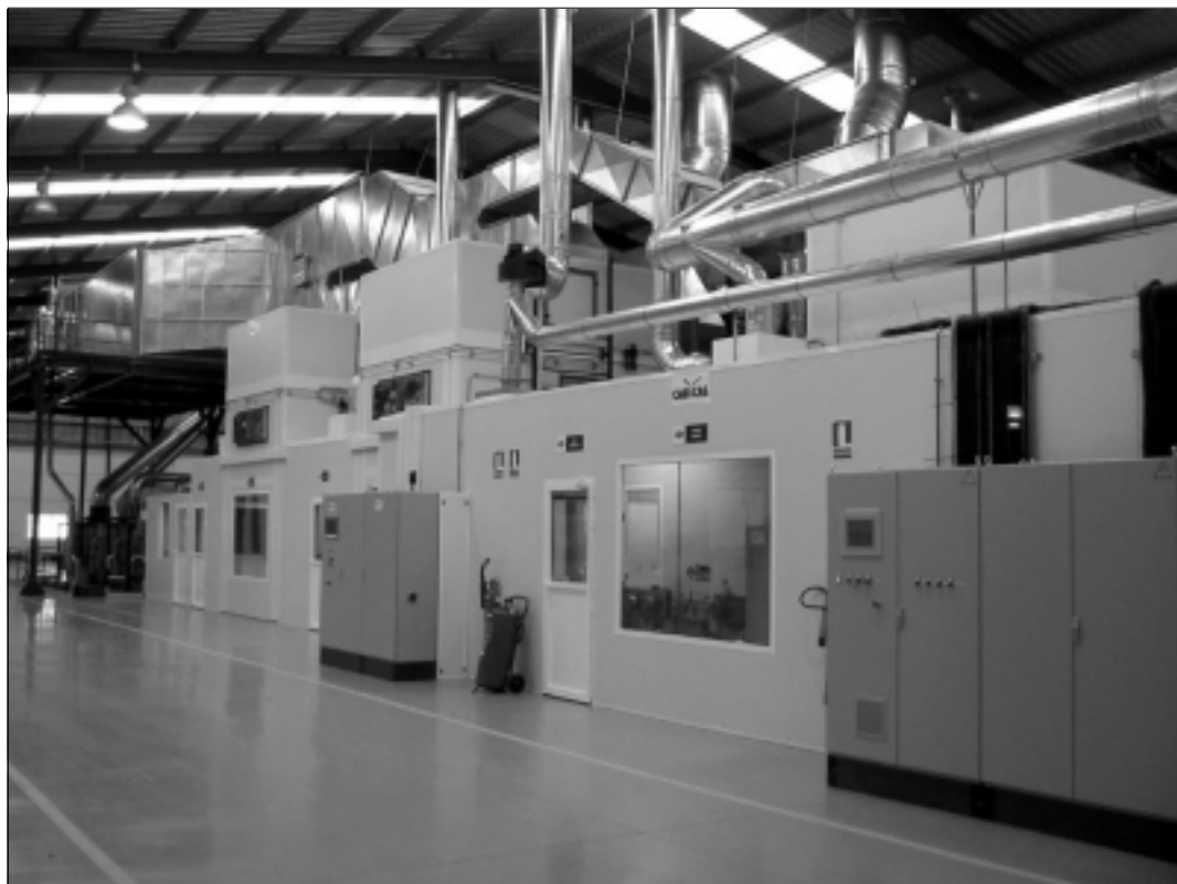
1 – Una vista general de la instalación para pintar componentes de automoción de plástico (Cabycal)
