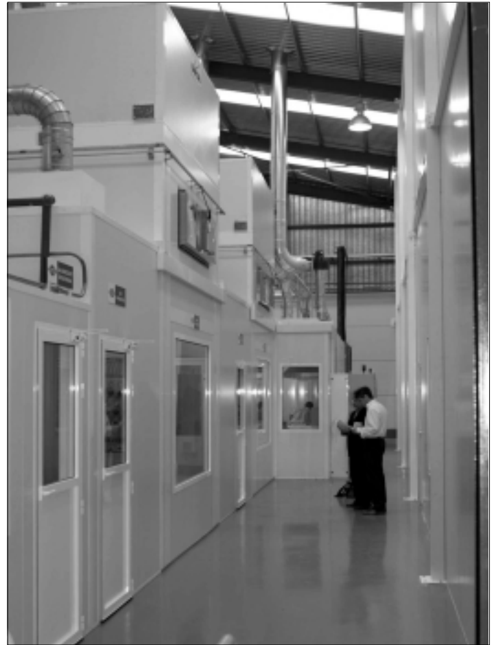
6 – La línea de las cabinas, de las pre-evaporaciones y las entradas de inspección
