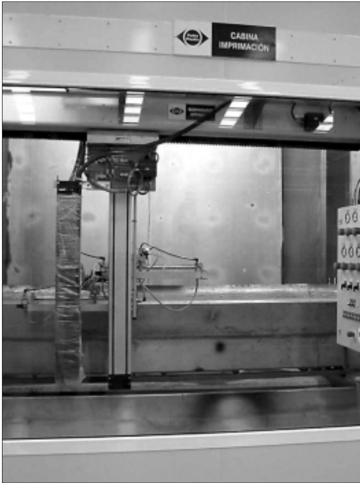
5 – La primera cabina de aplicación, robotizada. El transportador de suelo garantiza la máxima precisión de colocación de las piezas delante del sistema automático de aplicación
