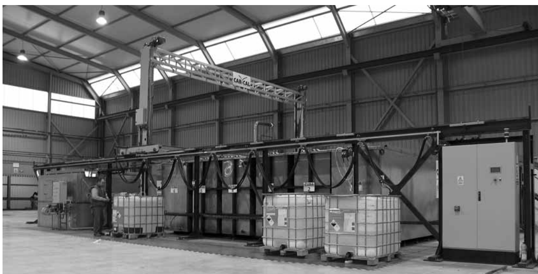
3 - Vista de la línea de pretratamiento de cubas.
