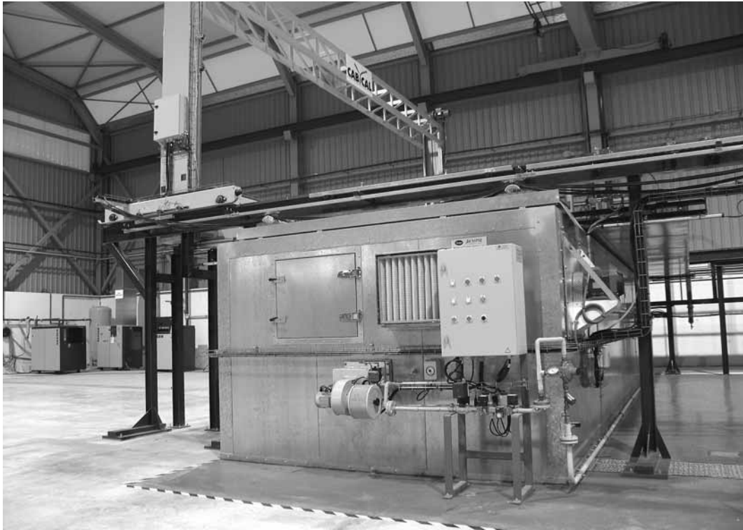
4 – El horno Pit desde abajo (zona de los servicios correspondientes).
