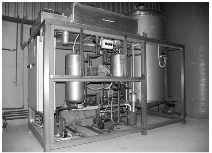
7 - El evaporador que permite cerrar el ciclo de las aguas (vertido "cero" de las aguas residuales).
