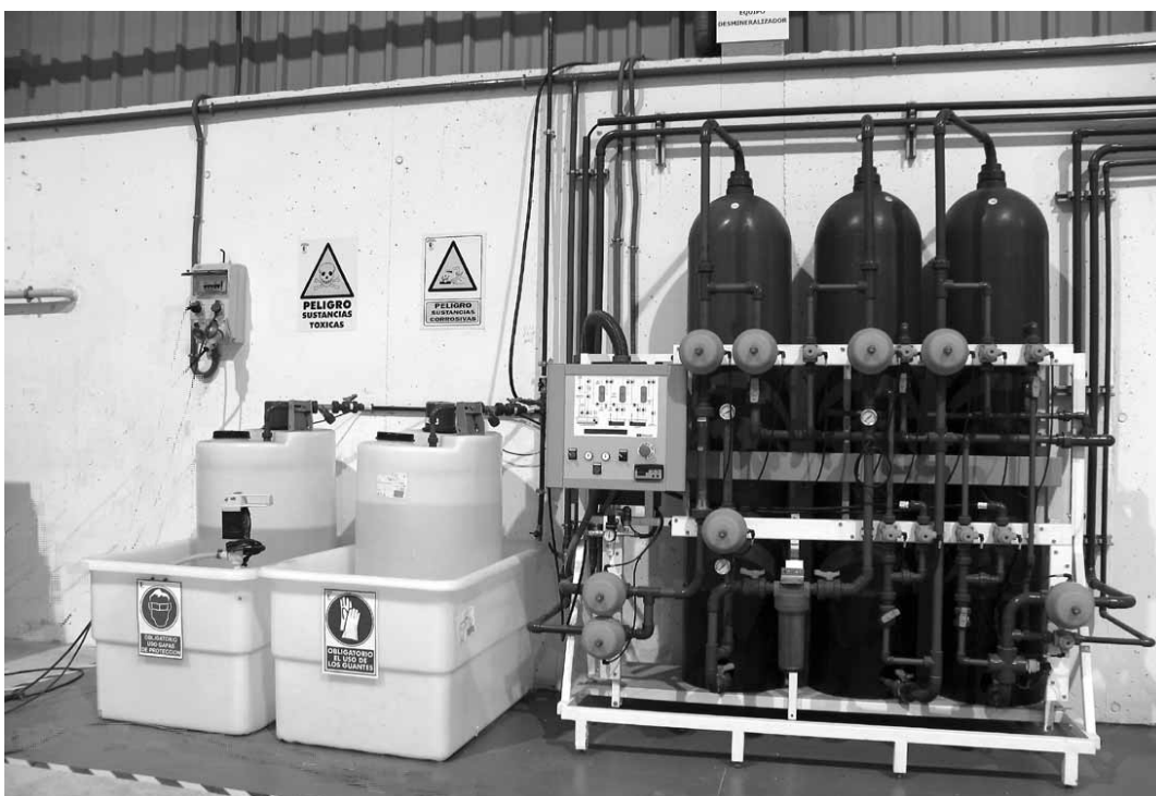
8 - El desmineralizador que trata las aguas destinadas a los enjuagues.
