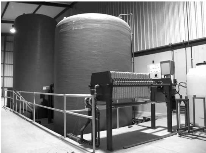
6 - La parte de depuración físico-química de la instalación de depuración de las aguas residuales.
