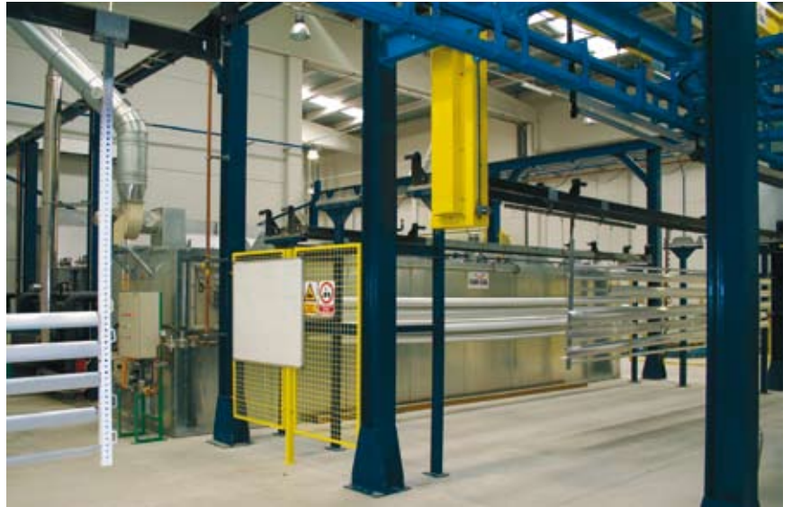
11 – Una vez tomado el bastidor de la unidad de enfriamiento, la grúa de puente lo carga en la línea de lacado, automáticamente.
