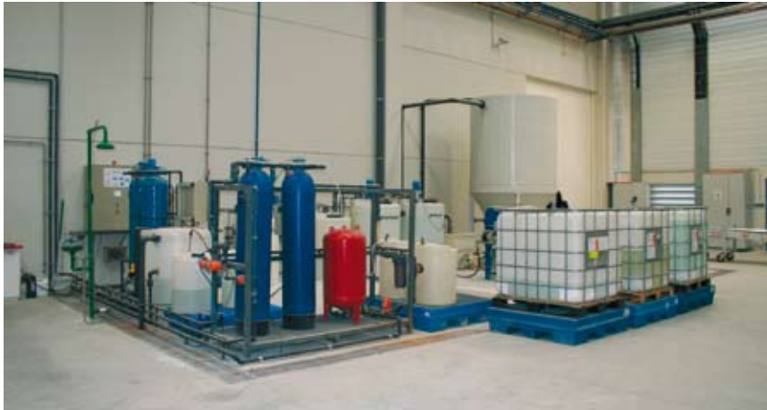
6 – La plataforma de los servicios de la instalación del pretratamiento.
