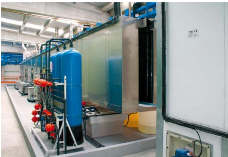
9 – O desmineralizador, que reabastece o último enxágüe do túnel de pré-tratamento.
