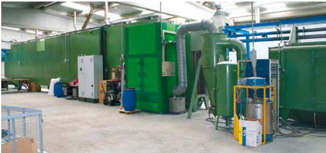
4 – Una vista del tramo de aplicación y polimerización. Cabina y horno proceden de la línea anterior.
