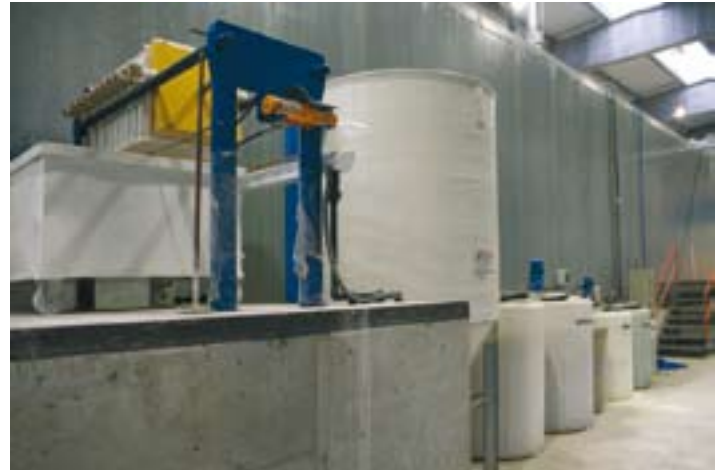
12 – El depurador de tipo físico-químico, con filtro-prensa para deshidratar completamente los lodos.
