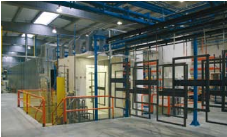
15 – La cabina de aplicación automática de cambio rápido, de material dieléctrico, instalada en foso.
