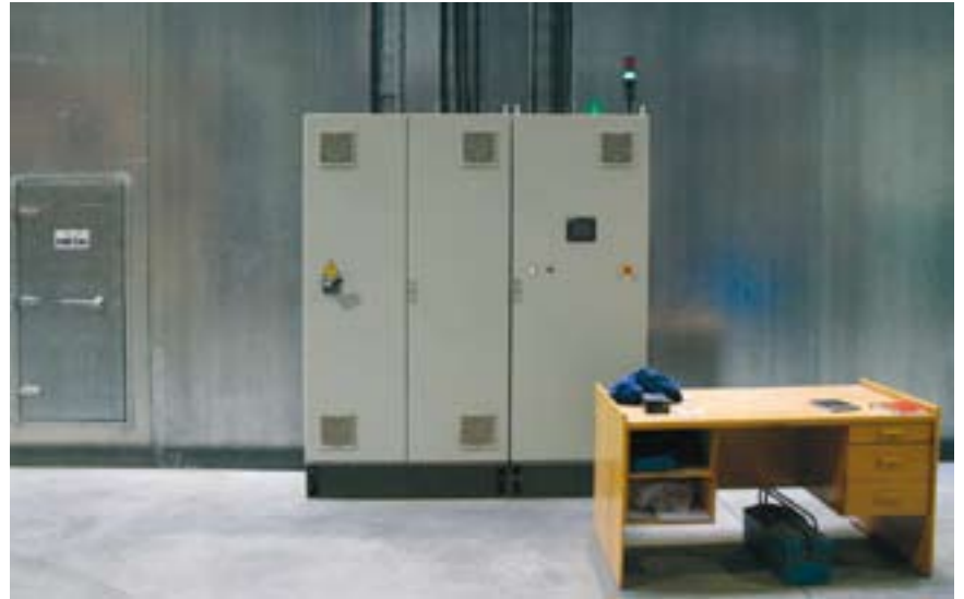
19 – El cuadro central de mando de la instalación.
