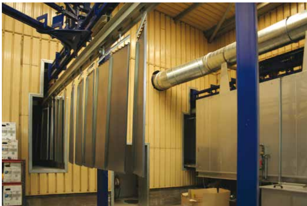
16 – El horno de secado ocupa un pequeño espacio del almacén de materiales en la entrada. En la imagen, pueden observarse la puertas de entrada y salida del horno.
